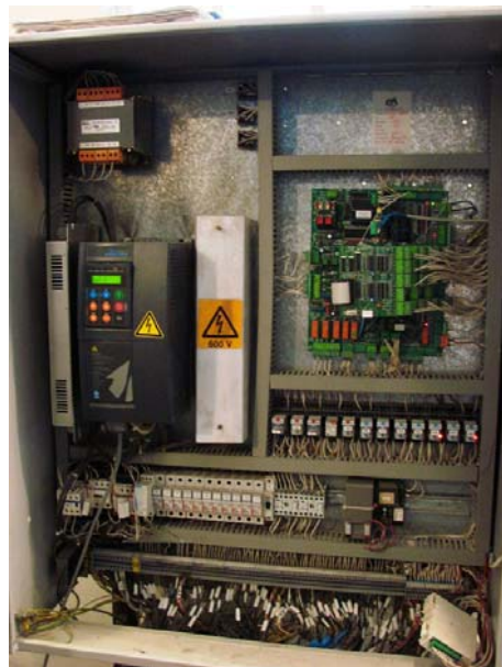
szafa sterownicza dźwigu nr 2
