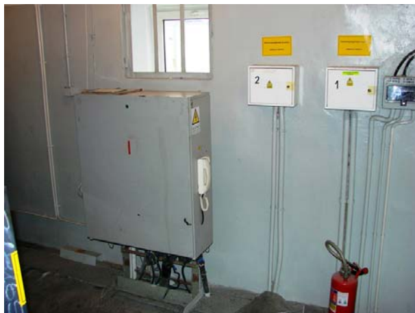
szafa sterownicza dźwigu nr 1
