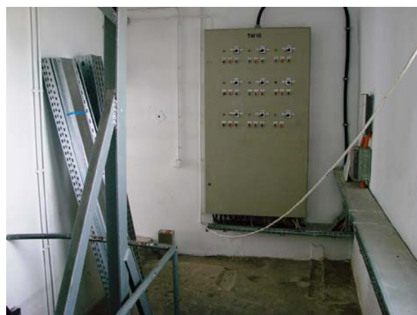
szafa sterownicza wentylacji
