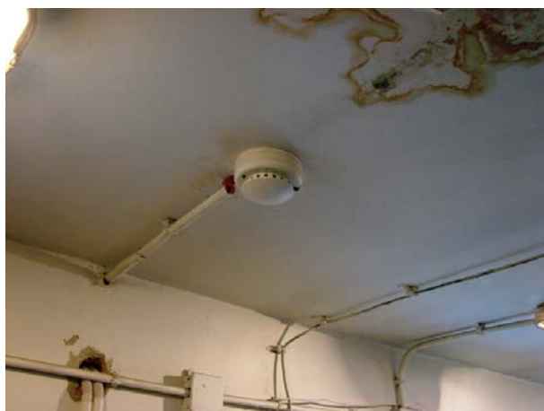
czujka systemu sygnalizacji p.poż.
