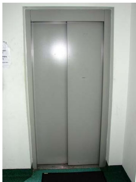
drzwi dźwigu nr 2 na XII piętrze
