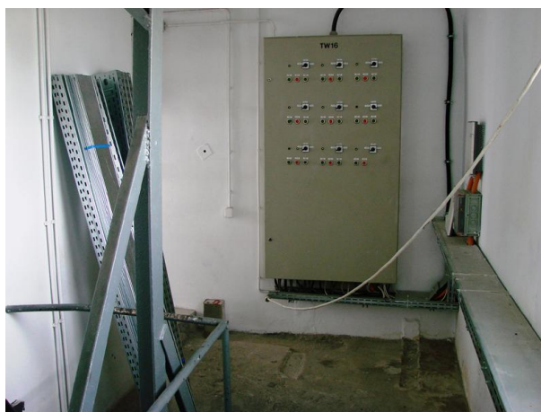
szafa sterownicza wentylacji
