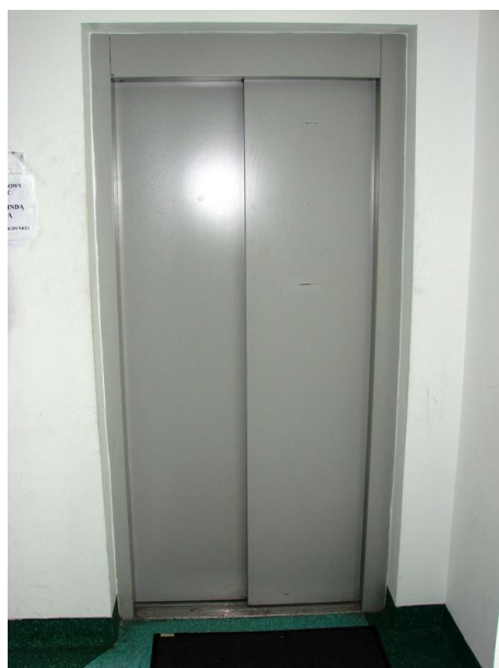
drzwi dźwigu nr 2 na XII piętrze
