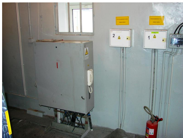
szafa sterownicza dźwigu nr 1
